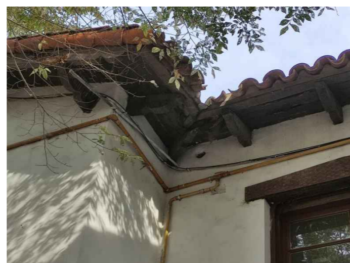
Aleros a reparar
