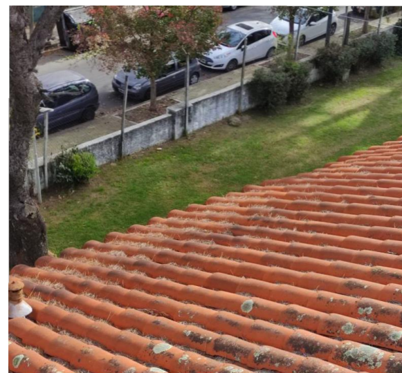
Acumulación de ramas, hojas y tierra, en particular en los canales entre las tejas.
